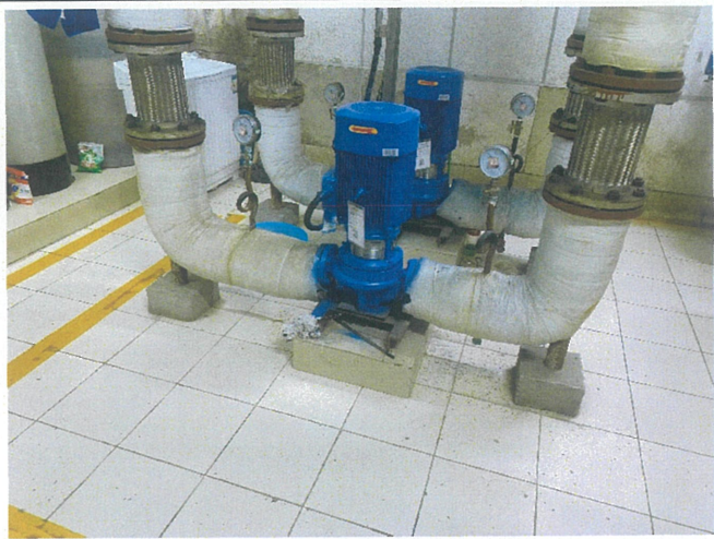
图 7.7 锅炉房减震基础和软连接
