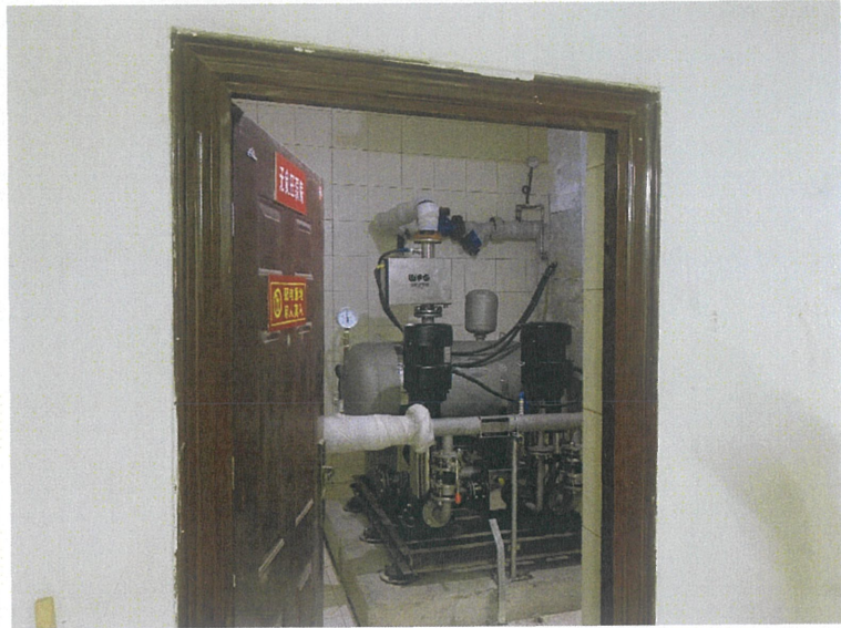
图 7.3 地下泵房现场照片
