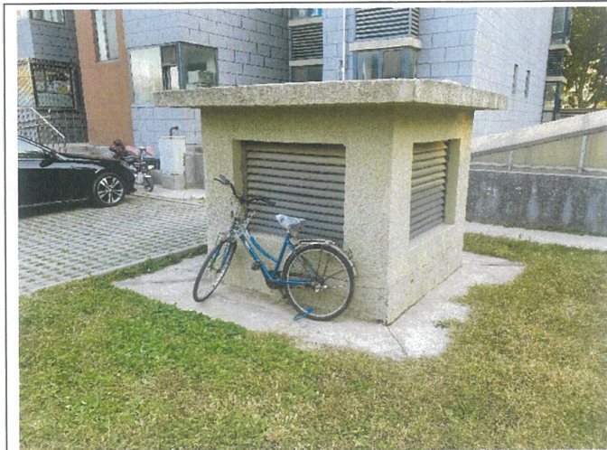
图 7.12 地下车库通风口
